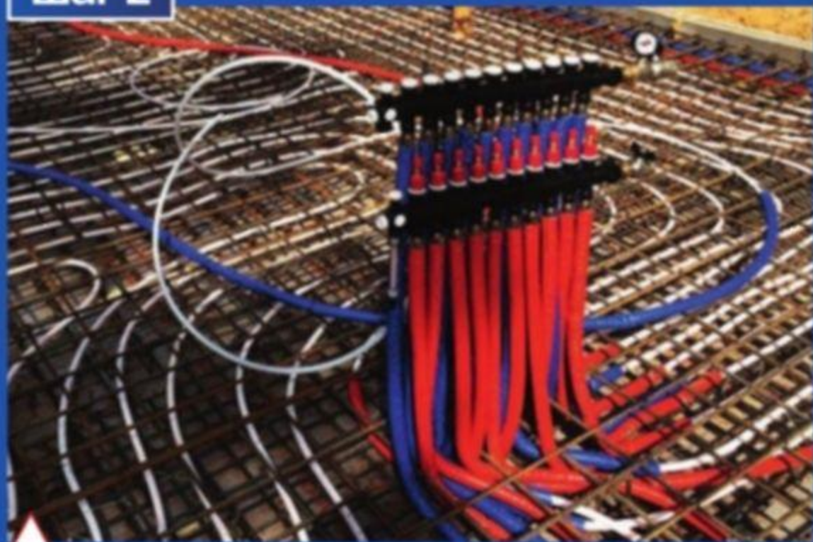
Коллектор водяных теплых полов
