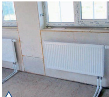
Радиаторная разводка системы отопления
