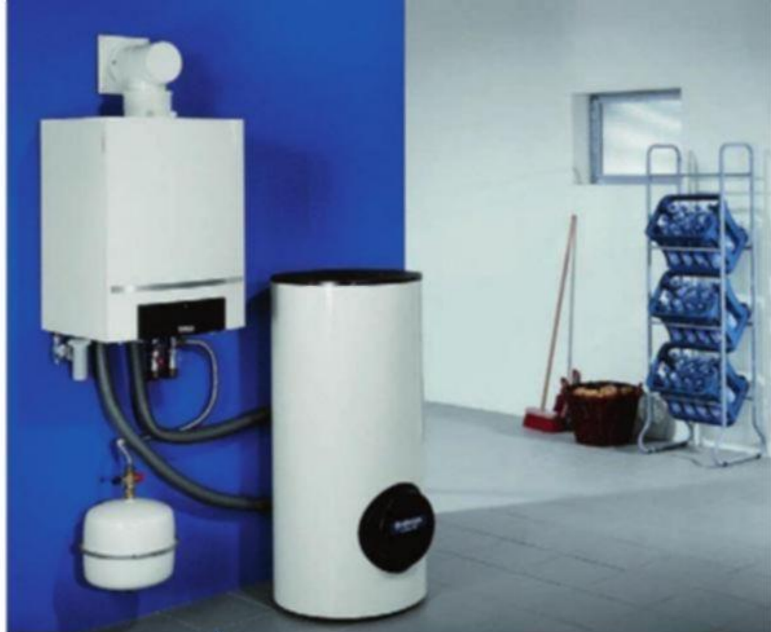
▲ Настенный одноконтурный котел Buderus, подключенный к бойлеру
