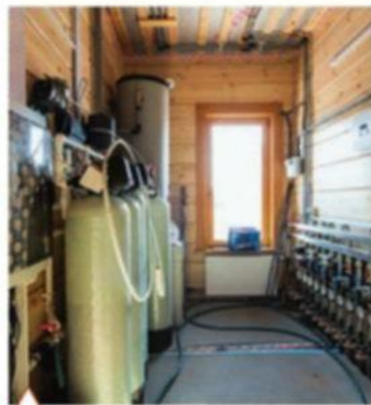
Котельная с установленным техническим оборудованием
