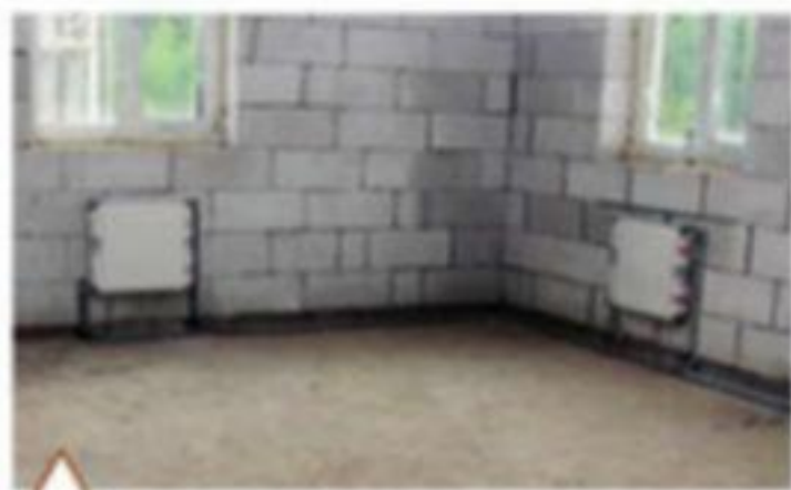
Отопительная разводка подключена к радиаторам
