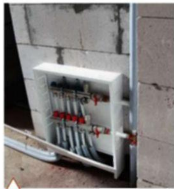
Коллектор системы отопления
