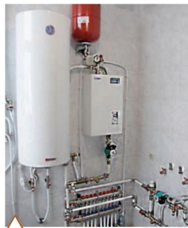
Оборудование технического помещения
