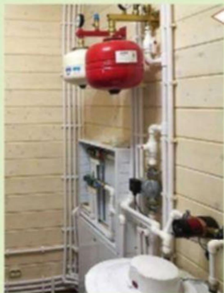
Комплексная станция очистки воды
