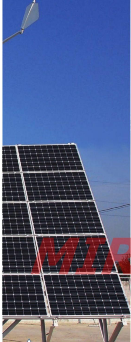
Солнечные батареи и ветрогенератор
