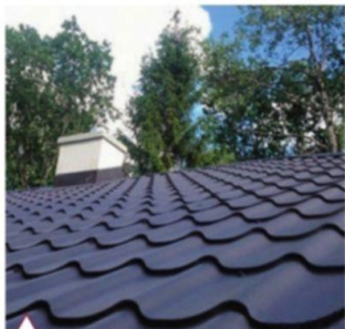
Кровельное покрытие из металлочерепицы
