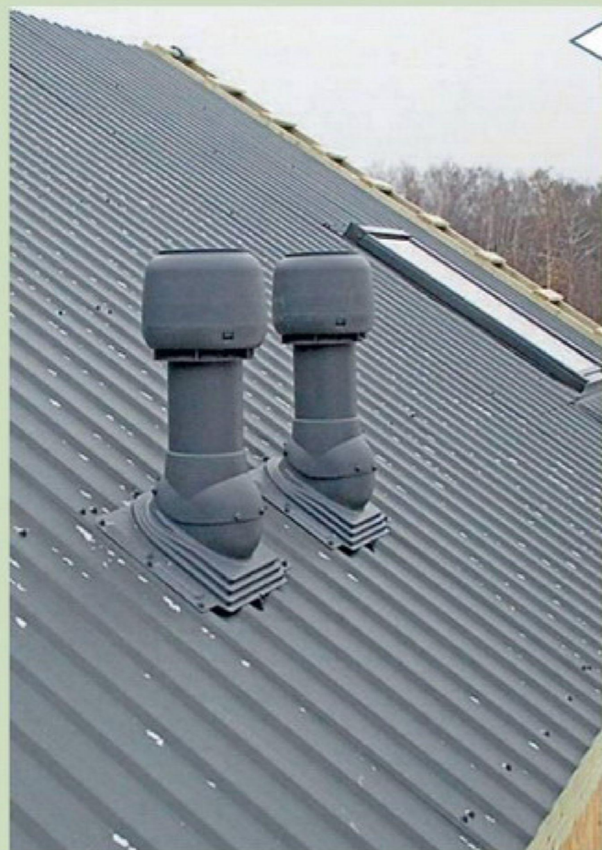
Вентиляционные элементы на стальной профилированной кровле
