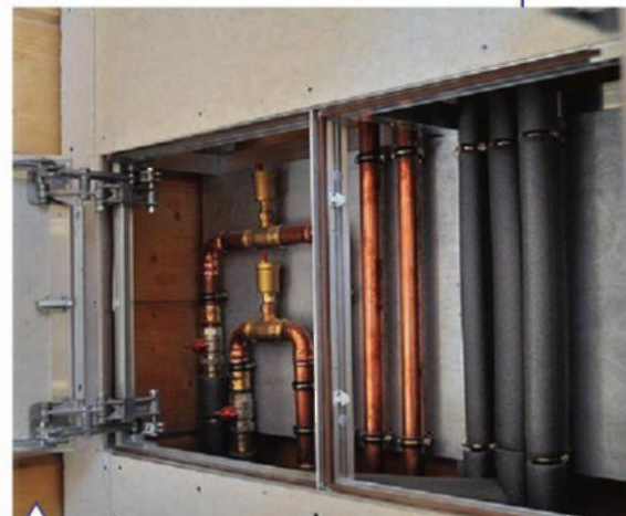
Медные трубы в специальном гипсокартонном коробе
