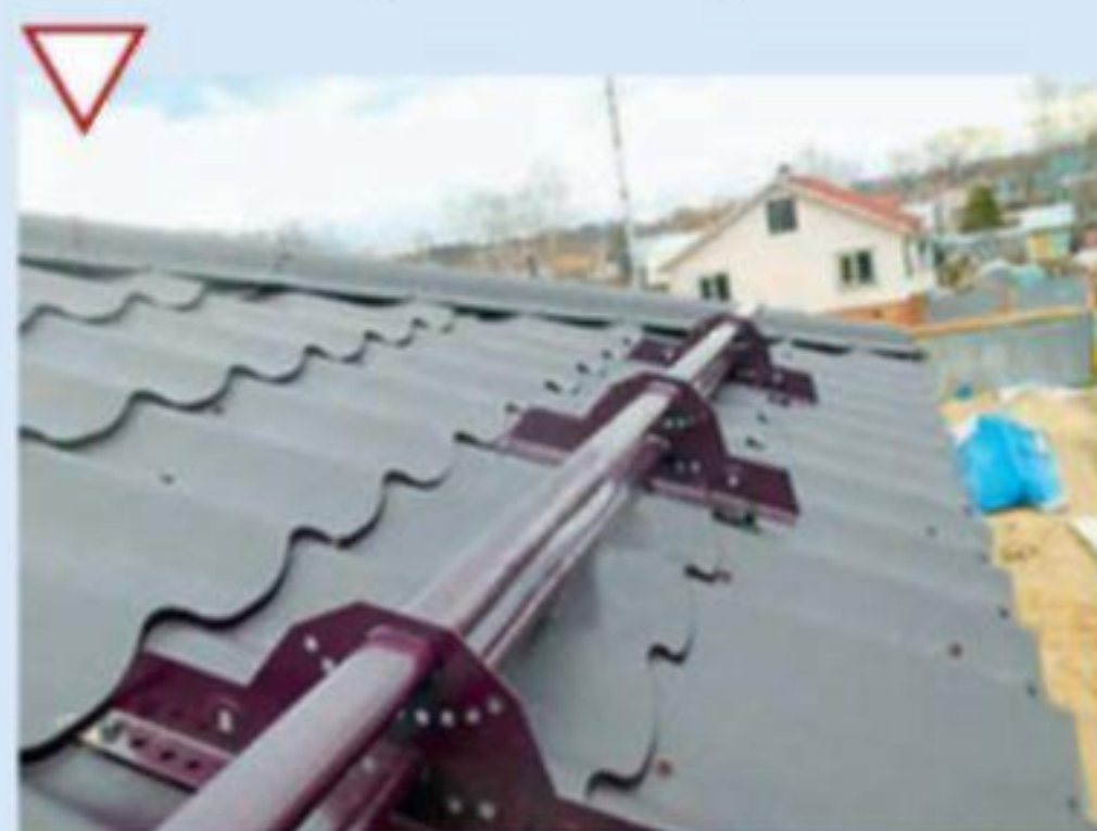
Элементы снегозадержания на металлочерепичной кровле
