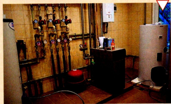
Котельная с установленным оборудованием
