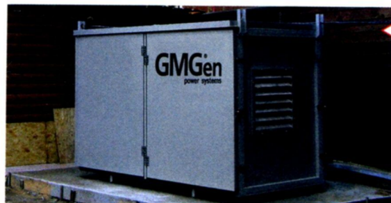
Дизельная электростанция GMGen в кожухе
