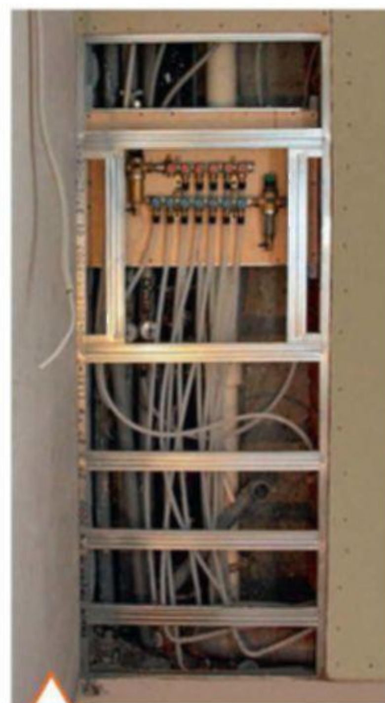
Распределительный узел системы водоснабжения дома
