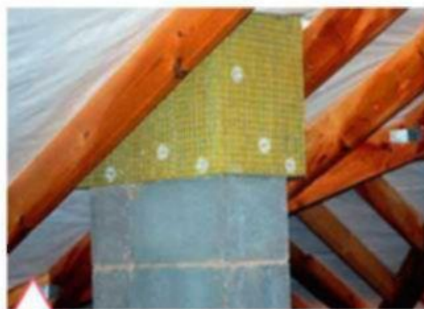
Негорючая теплоизоляция дымохода защищает стропила от перегрева при аварийной ситуации
