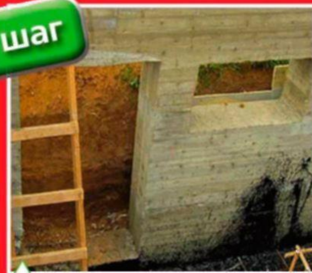
Проемы в стене фундамента
