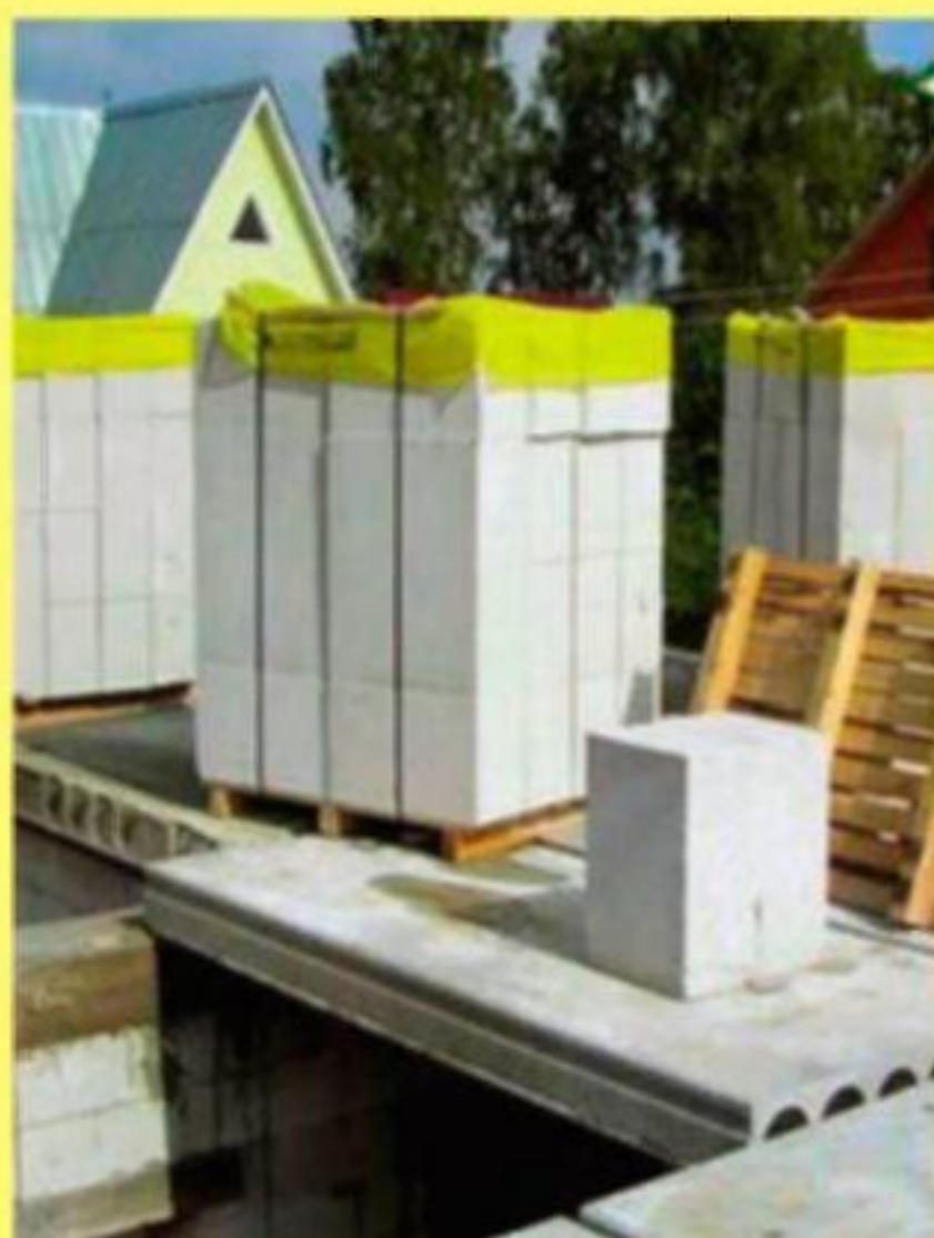
Складированные на перекрытии первого этажа блоки в ожидании возведения фронтонов мансардной крыши
