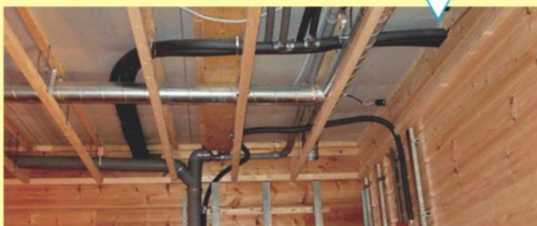
Разводка инженерных коммуникаций
