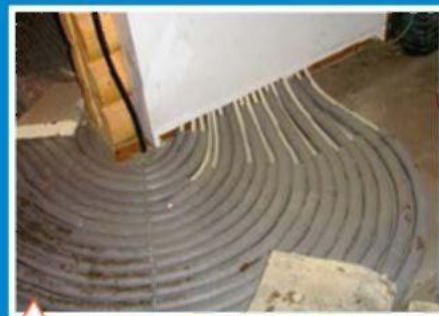
Горизонтальная разводка трубопровода, подвешенного к распределительному блоку
