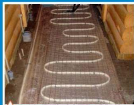
Отопительный контур водяных теплых полов для обогрева санузла первого этажа
