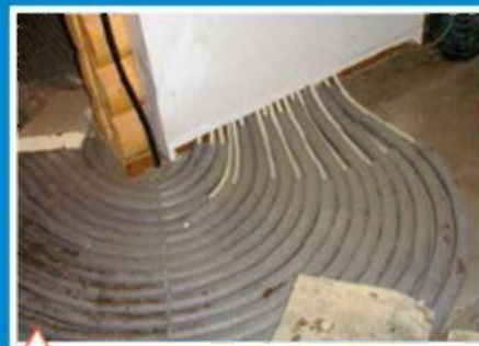
Горизонтальная разводка трубопровода, подвешенного к распределительному блоку
