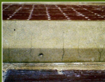
Некачественный монтаж декоративного каменного карниза
