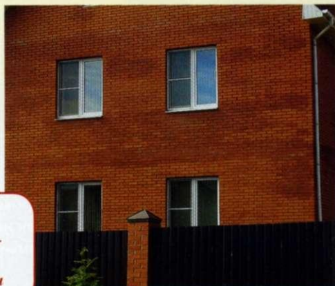
Мокрые фасады из-за некачествен- ного возведения трехслойных стен
