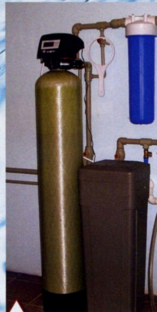
Фильтр-умягчитель и фильтр тонкой очистки
